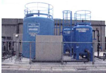
清浄海水施設のろ過器と水槽
